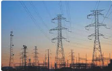
Đường dây điện cao thế.
